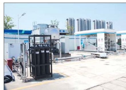
加氢站配备两台500kg氢气压缩机、18立方储氢瓶组。
