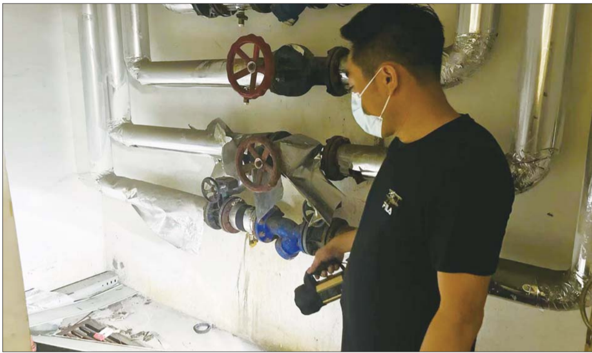
许庄街道京杭佳苑社区第四党支部书记白永镇在对漏水情况进行排查。
