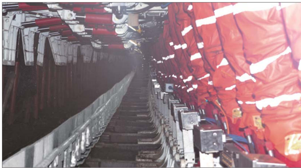
鹿洼煤矿建成全市地方煤矿首个智能化采煤工作面。
