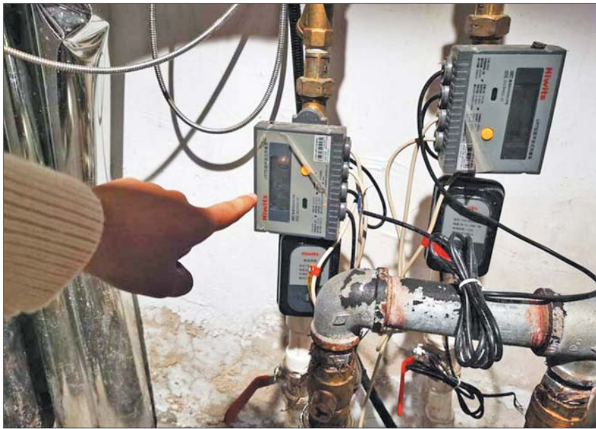
伏先生所在小区供热计量表的总表仍然显示为0。
