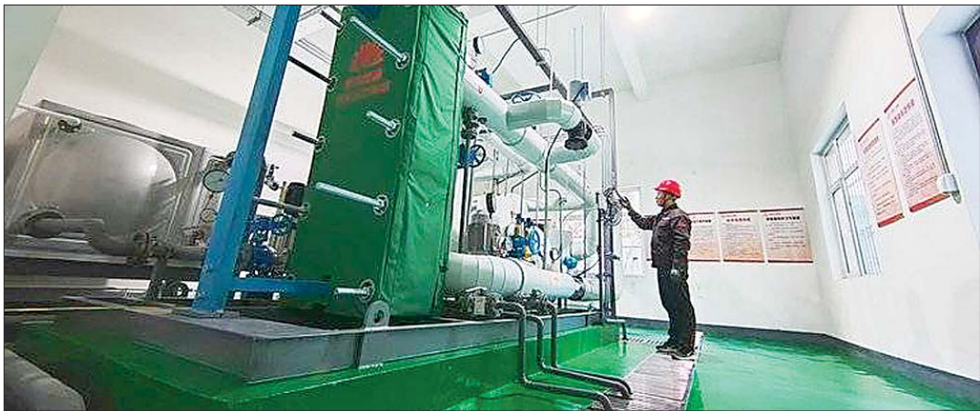
从自管站升级而来的换热站焕然一新。
