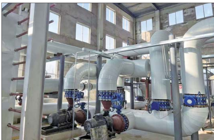
新建的海阳度假区核能换热首站正式投入使用。
