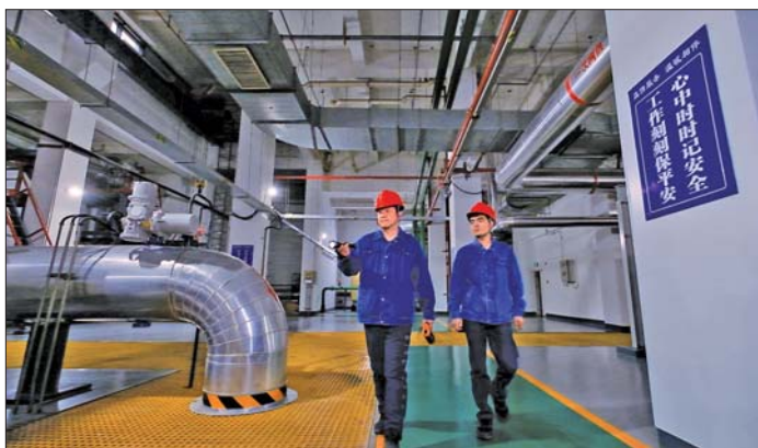
东泰热力工作人员正在巡检供热设备。
