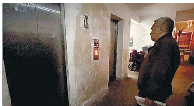
德裕家园小区的电梯已经很破旧。
