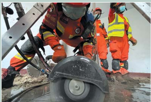
▲有人被困一楼废墟,救援人员只能通过向下安全破拆的方式进行施救。
