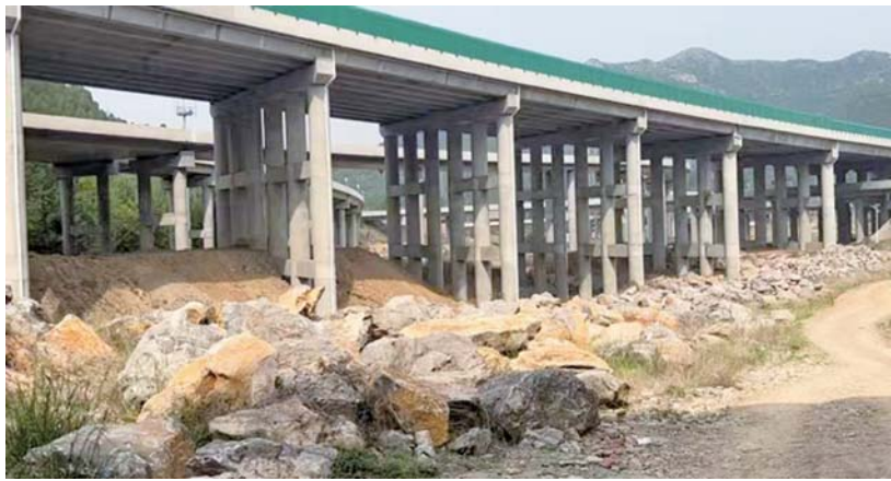
大量废弃石渣、混凝土堆在高速公路下以及河道边,下河河道变窄甚至被填埋。
