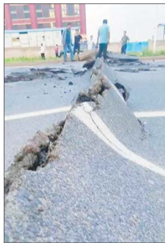
小区外的路面开裂隆起。
