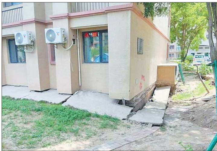
小区居民楼楼体和地面之间出现裂缝，路面明显沉降。
