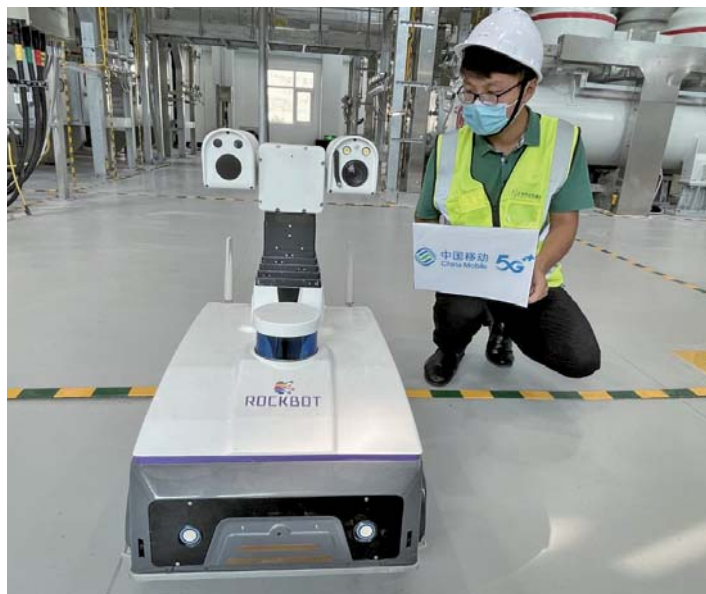
5G智慧巡检机器人正在工作。
