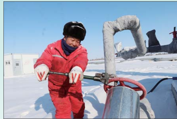
员工及时调整蒸汽掺排量，消除油井“低温高压”状态。
