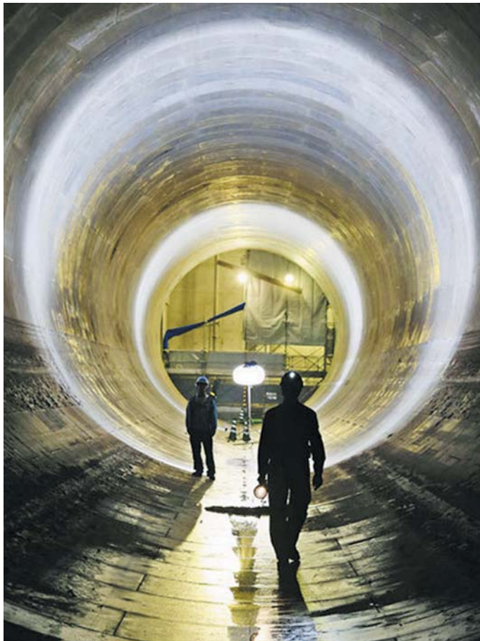
日本东京都的下水道设施。
