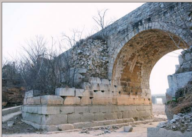
桥体西面，可以看到桥墩完整，但拱形部分已坍塌。
