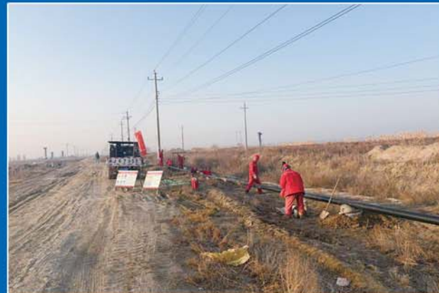
员工在接转站伴生气综合利用工程现场,高效推进各项施工。
