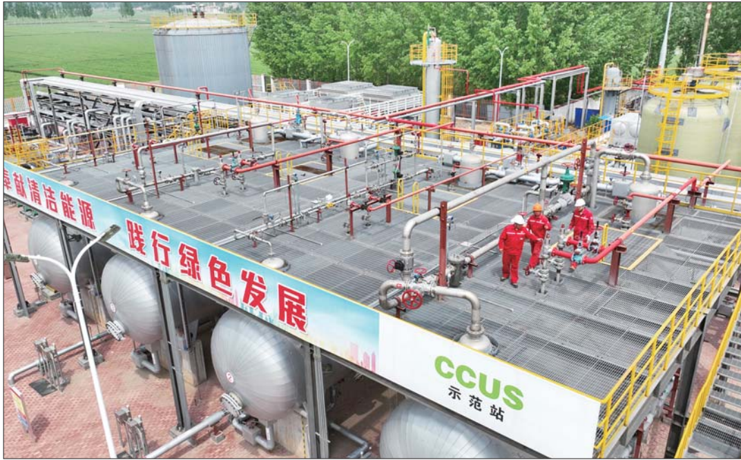
在胜利油田樊128CCUS注入站,员工检查设备运行情况,保障二氧化碳注入平稳运行。 通讯员 朱克民 摄
