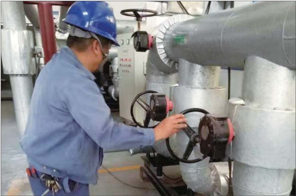
换热站内,工作人员启动换热机组,进行换热站巡查。
