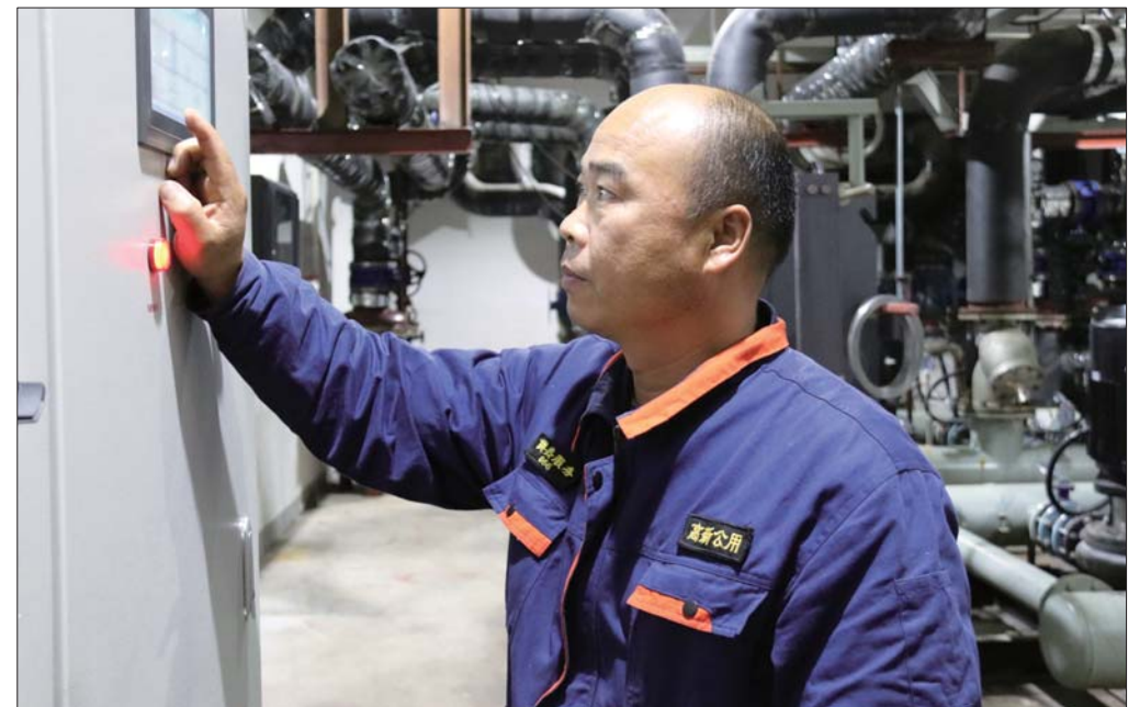
高新公用的工作人员正在监测换热站数据。
