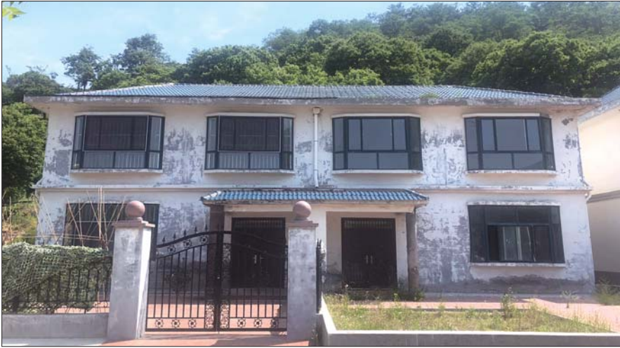
“无人认领”的别墅,由于年久失修,外墙皮已经开始脱落。
