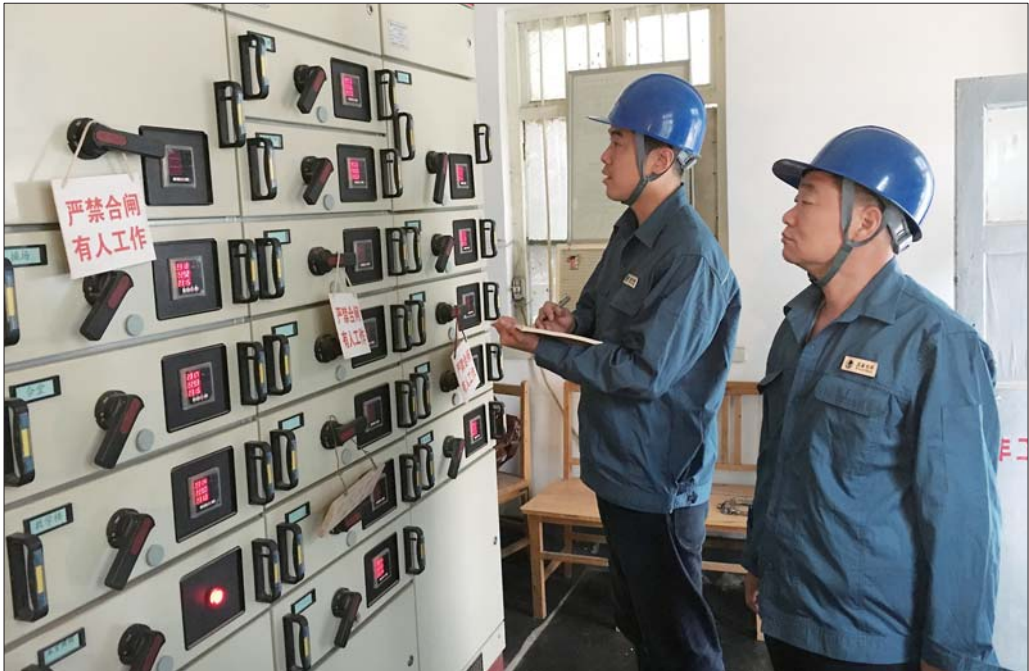
高考前,济南供电公司一线工作人员到济南一中配电室检查。
