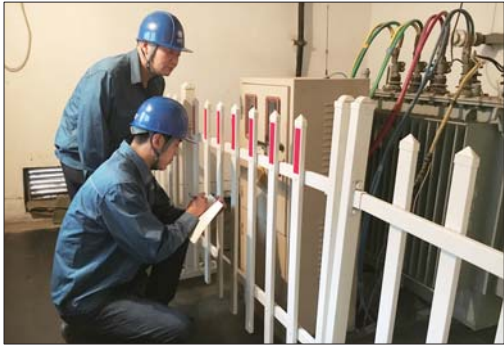
工作人员在山师附中检查供电设备。
