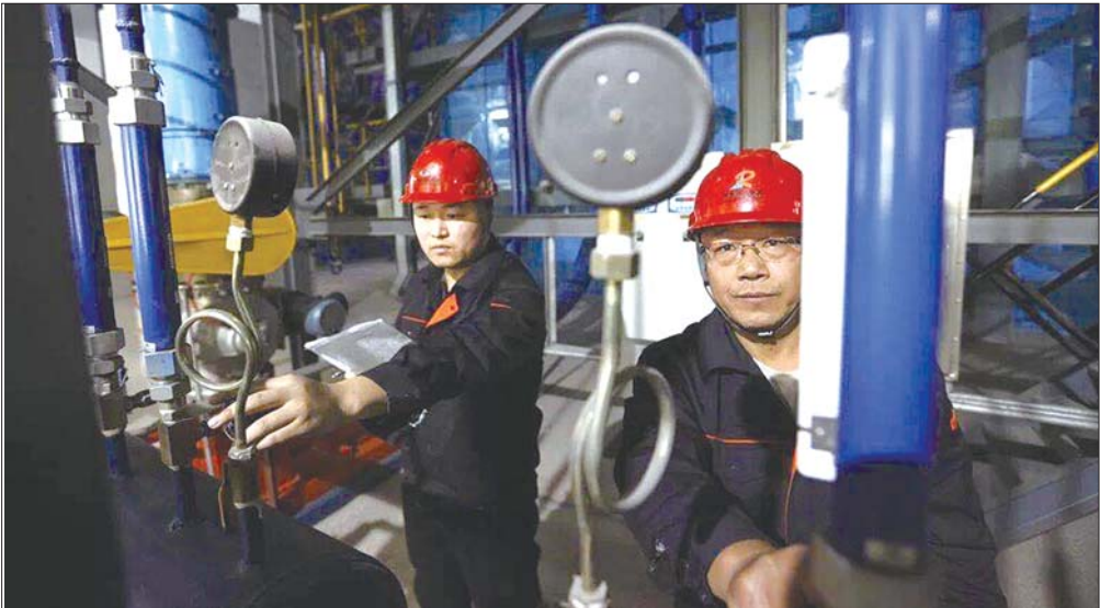
济南热力工作人员检查设备,做好应对准备。 济南热力集团供图
